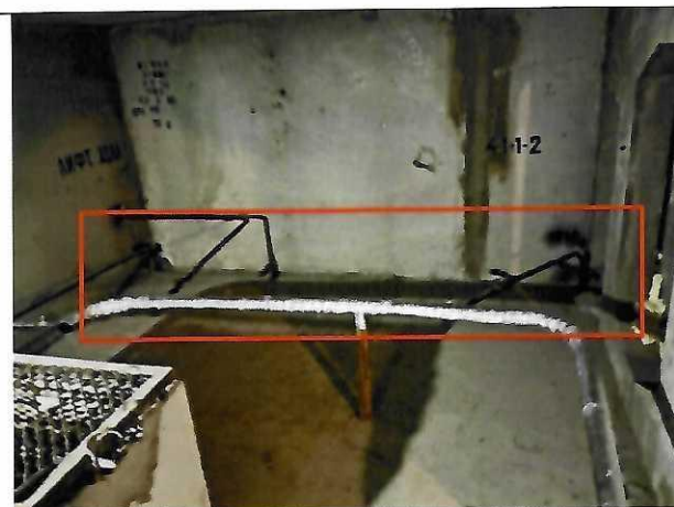
Фото 30. Отсутствие тепловой изоляции в подъезде №4
