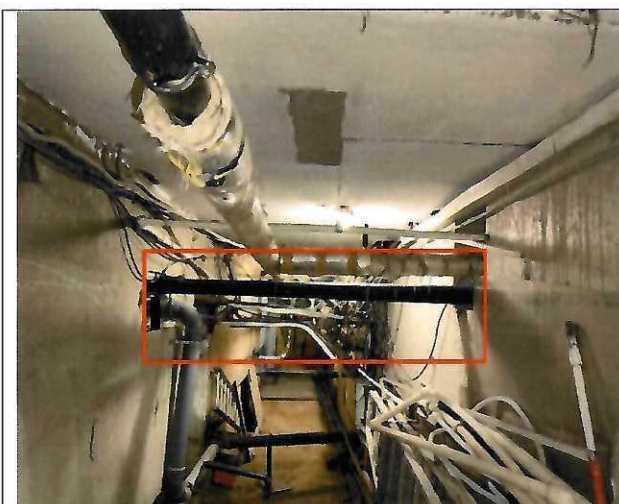
Фото 19. Трубопроводы системы отопления без теплоизоляции
