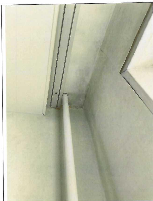
Фото 5. Визуально около трубопроводов выявлены многочисленные подтеки в кв. №197
