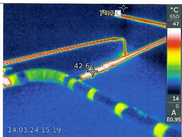
Фото 25. На трубопроводах с тепловой изоляцией видны пропуски (теплоизоляция не корректно смониторована).
