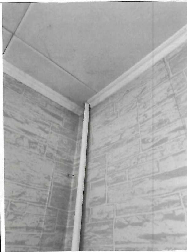
Фото 6. Визуально выявлены отсутствия футляров между плитой перекрытия и трубой кв. №197
