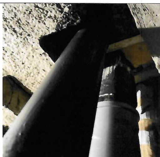
Фото 20. Отсутствие тепловой изоляции, футляр отсутствует.
