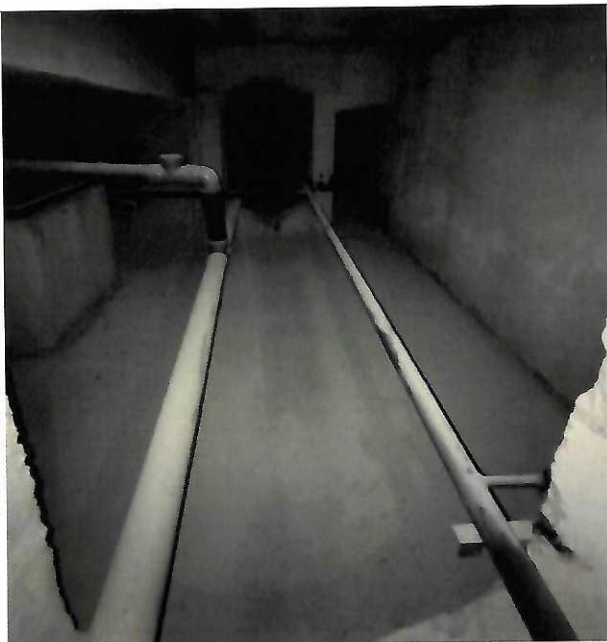
Фото 28. Трубопроводы тепловых сетей без изоляции на чердаке (подъезд 1,2,3 полностью отсутствует тепловая изоляция)
