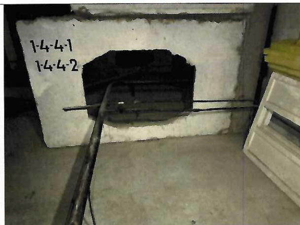
Фото 27. Чердачное помещение. Тепловые сети без теплоизоляции.
