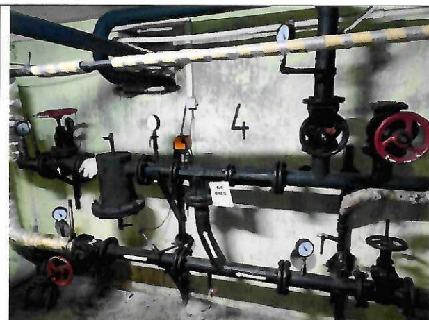
Фото 21. Элеваторный узел подъезда №4
