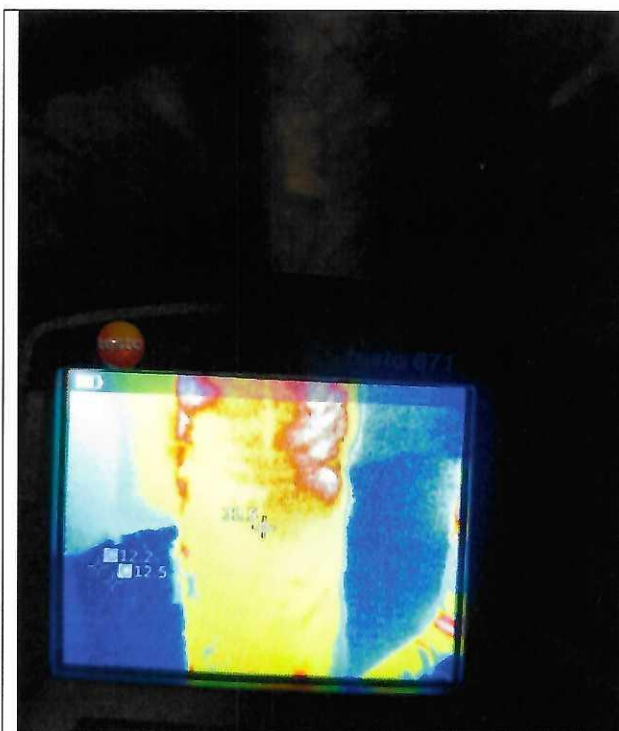
Фото 24. Нарушение тепловой изоляции на трубопроводах
