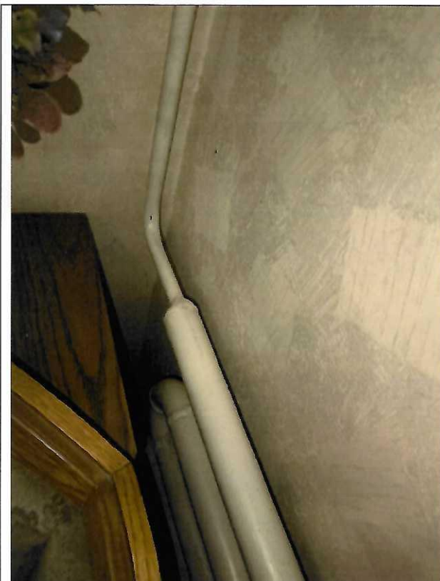
Фото 1. Трубная система в квартире №200 расположенная на кухне. Не допускается (не предусмотрена проектом)
