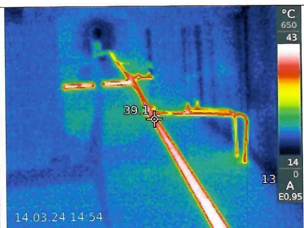
Фото 29. Термограмма в чердачном помещении
